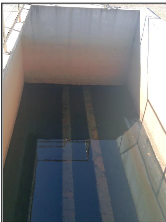
Figura 20: Vista parcial dos Filtros.
