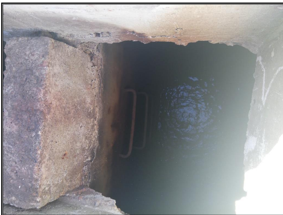
Figura 21: Vista parcial do tanque de contato.
