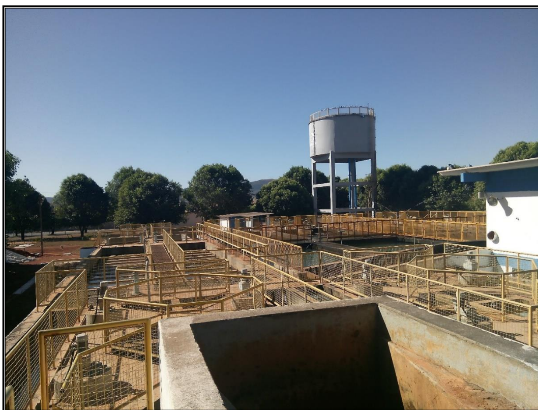
Figura 18: Vista parcial dos Floculadores.
