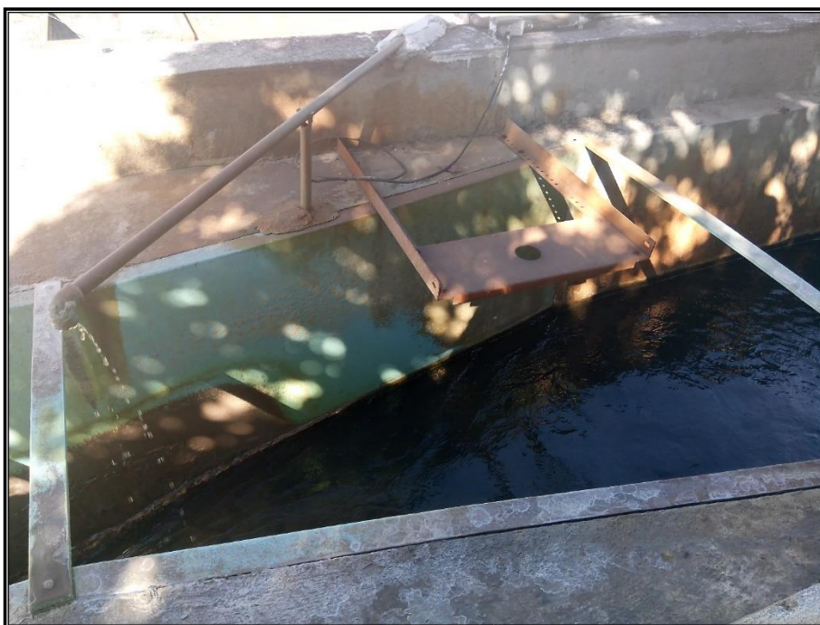
Figura 17: Entrada de Água Bruta na Calha, detalhe da dosagem de sulfato de alumínio e vestígios da instalação de medidor Ultrassônico.
