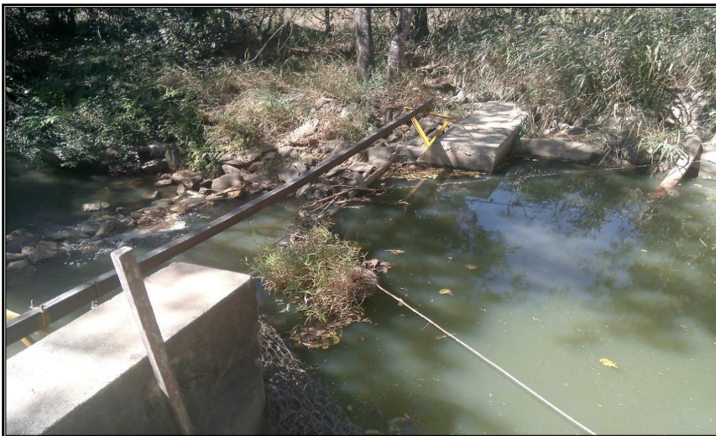
Figura 11: Captação de Água Bruta.
