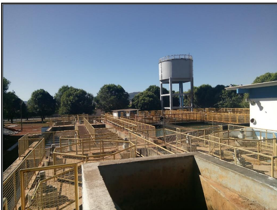
Figura 22: Vista geral do bloco hidráulico e detalhe ao fundo do reservatório de distribuição utilizado para retrolavagem dos filtros.
